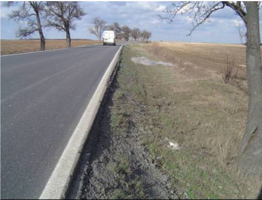
Figura 2. Falta de Borde en una Carretera de Alto Tráfico en un Suburbio de Praga 6 .
