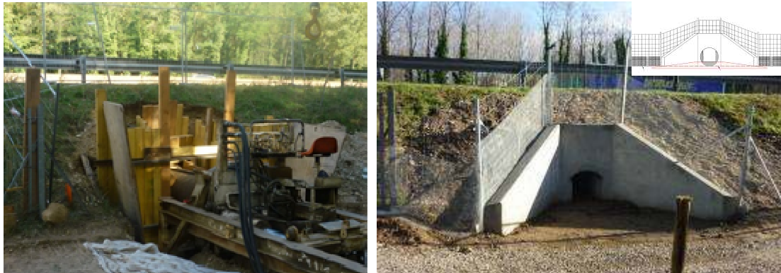
Figure 10 – Travaux de fonçage d'une buse en 800 mm (gauche) et aménagement achevé (droite) sur A7
