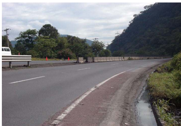
FIGURA 5 Condición de la Barrera Central en el Segmento 4
