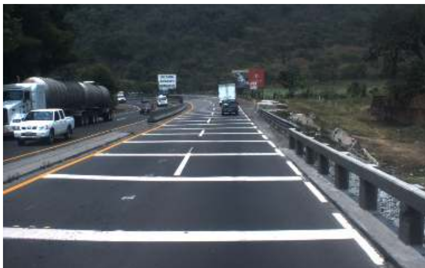
FIGURA 3 Reducción de la Sección Transversal en el Puente en el Segmento 2
