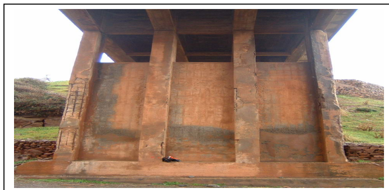
Figure 8- Dégradations au niveau du tablier et de la pile
