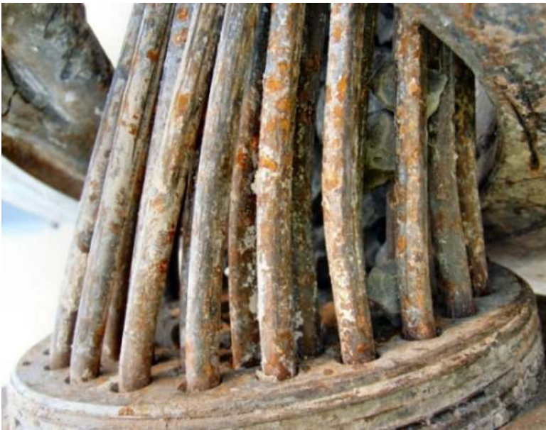
”Figure 1 – Mälkiä channel bridge, corroded prestressing steel”
