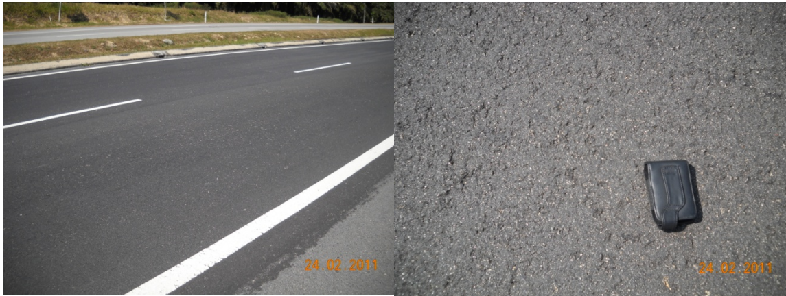
Figure 7: surface de la chaussée à la HIPR sans addition d'agent de rajeunissement
