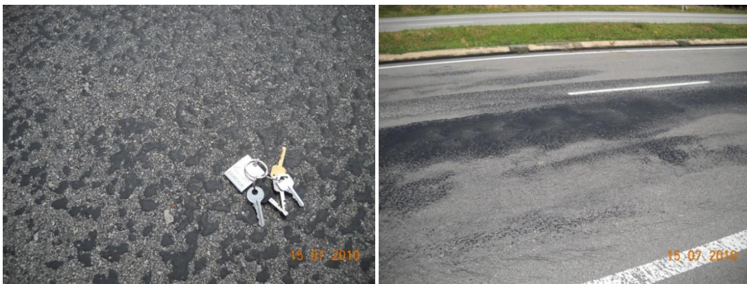
Figura 2 - Sangrado en el recién construido Lebu AMJ
