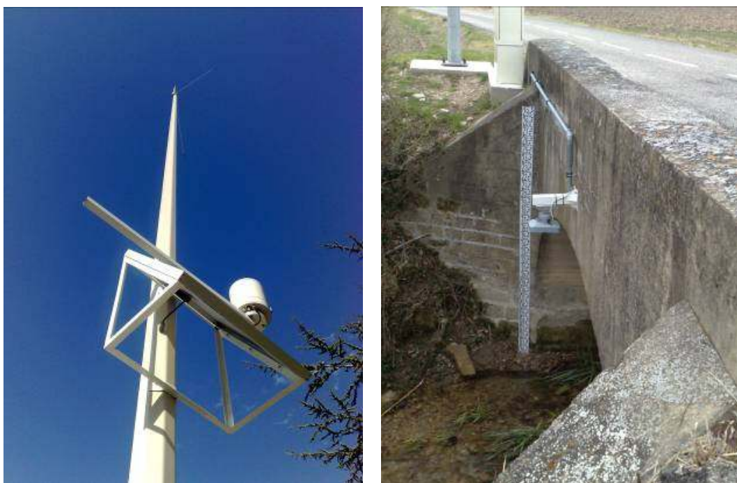
Figure 12 – Station pluviométrique automatique, avec système téléométrique incorporé, installée dans le cadre du projet TRACE
