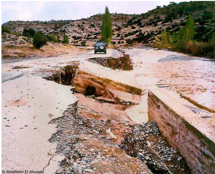
Figure 2 - Destruction d'une route provinciale par une crue soudaine dans les Montagnes de l'Atlas (Maroc, 2006)
