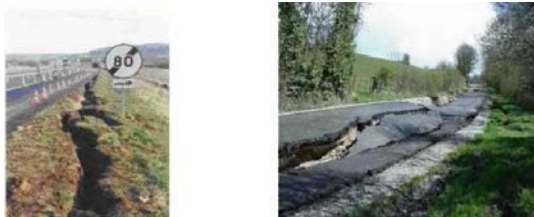
Figure glissements de terrain affectant le réseau routier
